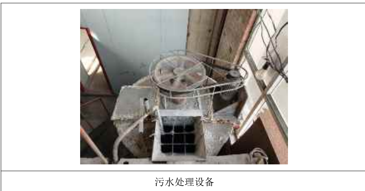
图 3-2 项目废水污染物处理措施现场照片
