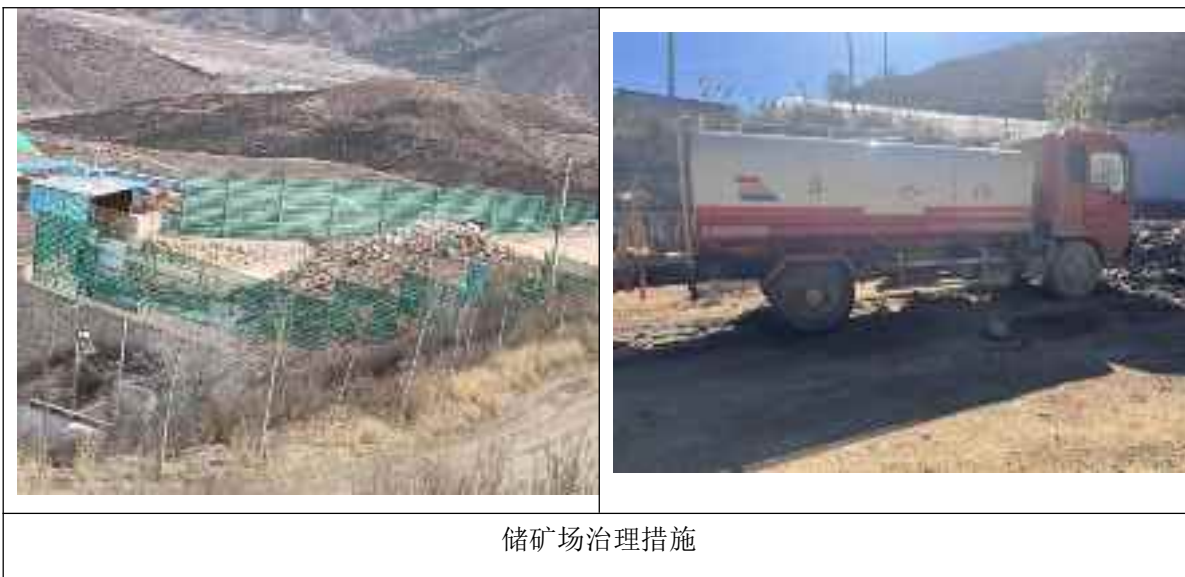
图 3-1 项目废气污染物处理措施现场照片
