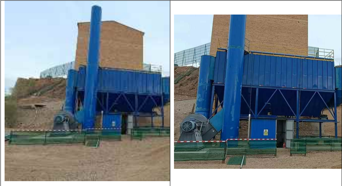
破碎车间治理措施
