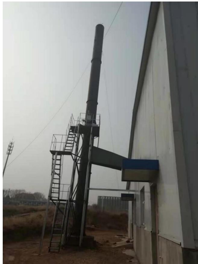
18m 高排气筒
